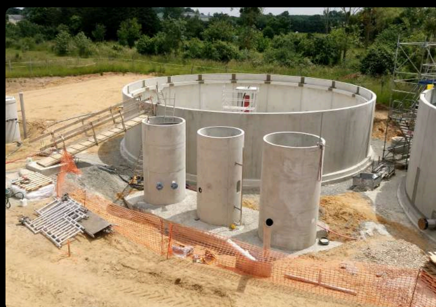
Ouvrages satellites STEP
