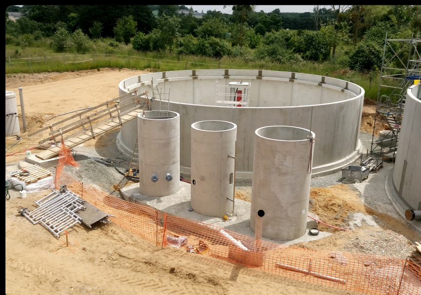
Ouvrages satellites STEP
